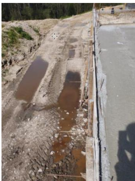
Figura 9: Águas contaminadas/escorrências na proximidade do pavilhão de estrume.
