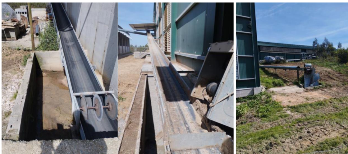
Figura 10: Tapetes de transporte de estrume, “reservatório”/tanque e conexões.
